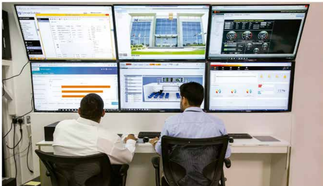
A iluminação é controlada por um aplicativo, por sensores de movimento e centralmente a partir de um sistema de gerenciamento. O projeto proporcionou uma redução entre 55% e 60% na carga conectada.
